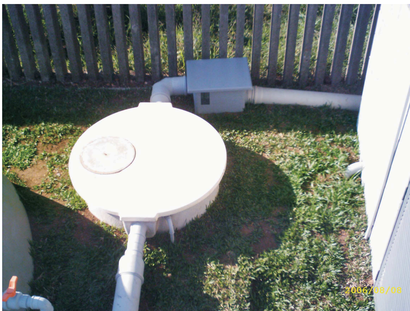
FIGURA 7 - Tanque de Contato
