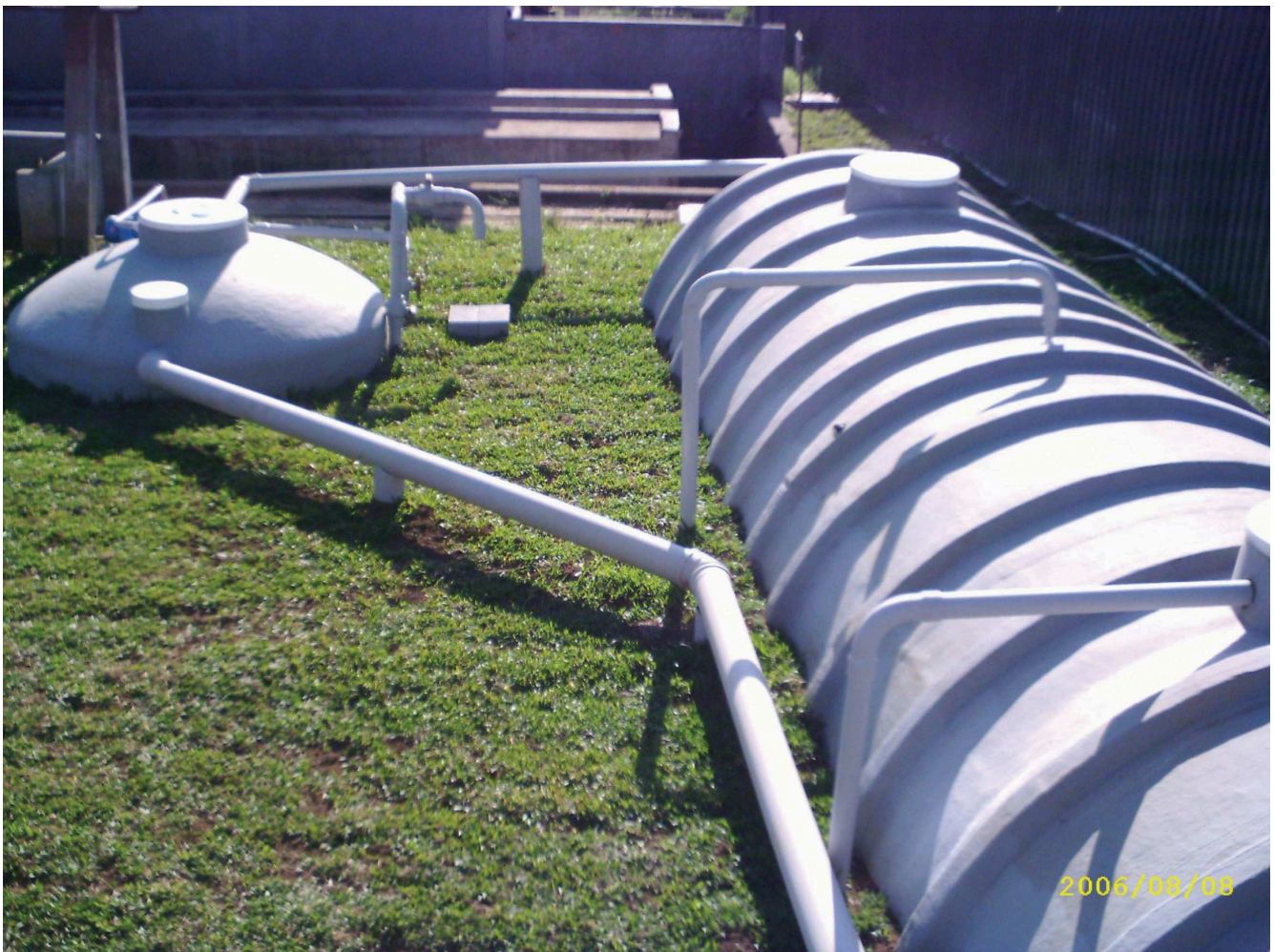
FIGURA 11 - Decantador e tanque de sedimentação
