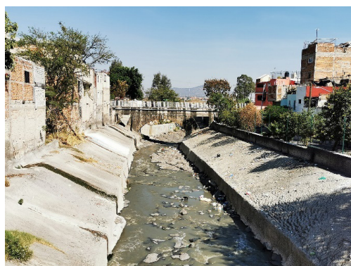
Figuras 8 - Arroyo Atemajac canalizado y contaminado. Fuente: Archivo de los autores.
