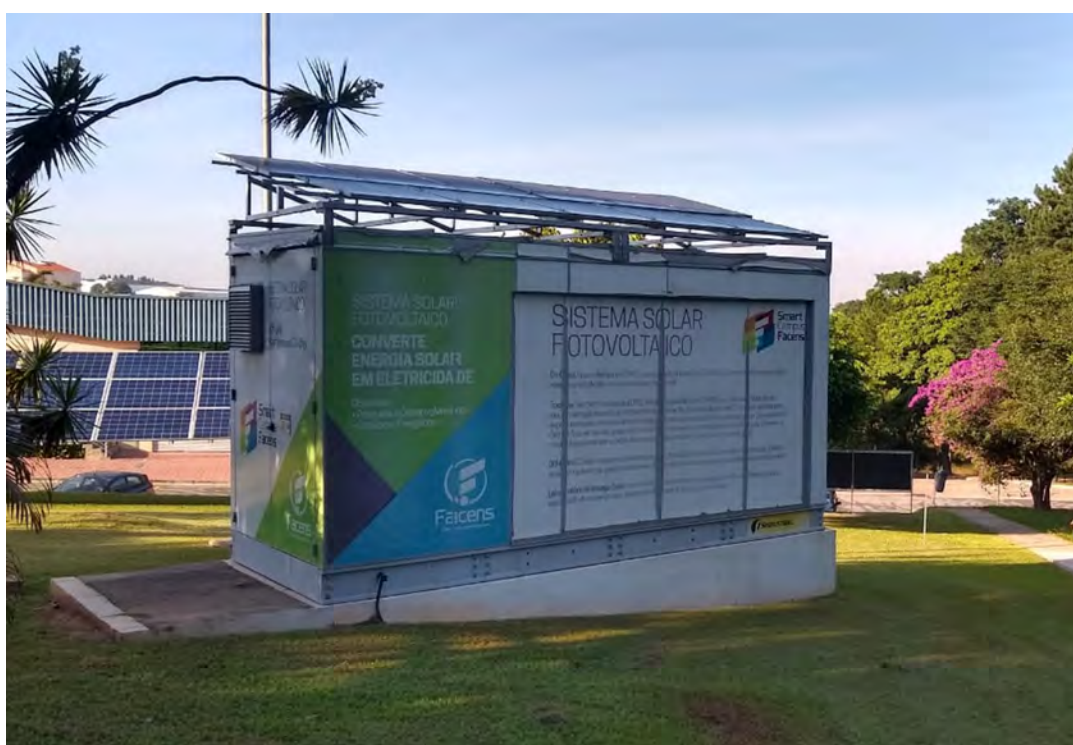
Figura 4 - Projeto Sistema Solar Fotovoltaico Centro Universitário Facens. Fonte: Próprio autor.
