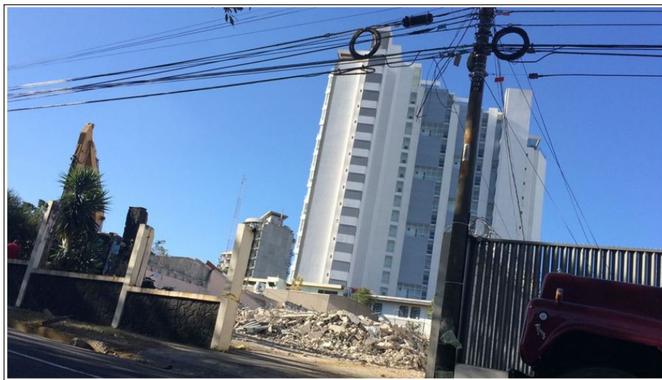
Figura 14 - Casa demolida para abrir espaço para futuros projetos residenciais verticais no bairro de alto padrão Rohrmoser Fonte: Acervo do autor (2016).
