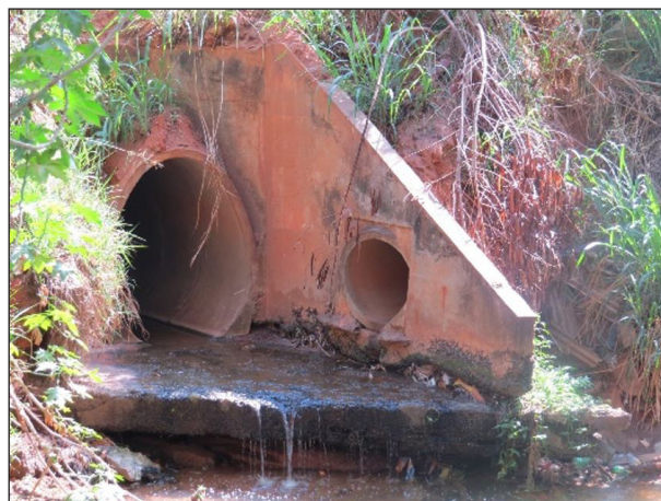
Figura 1 - Rede de drenagem e processos erosivos
