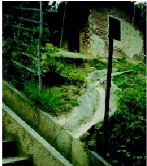
Figura 12 - Canaleta de drenagem acoplada à escadaria, no Córrego do Boleiro (Recife) e no Alto Santo Antônio (Camaragibe/PE) Fonte: FIDEM, 2004.
