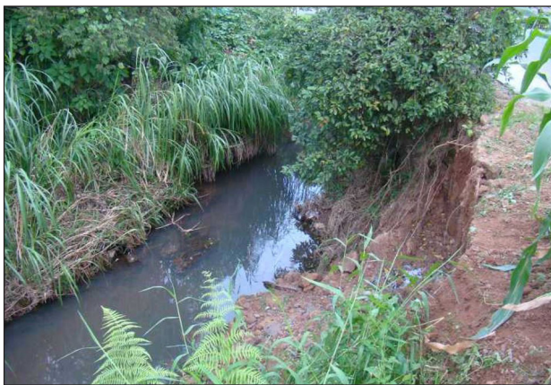
Figura 7 - Deslizamento e assoreamento na margem do Ribeirão Fortaleza
